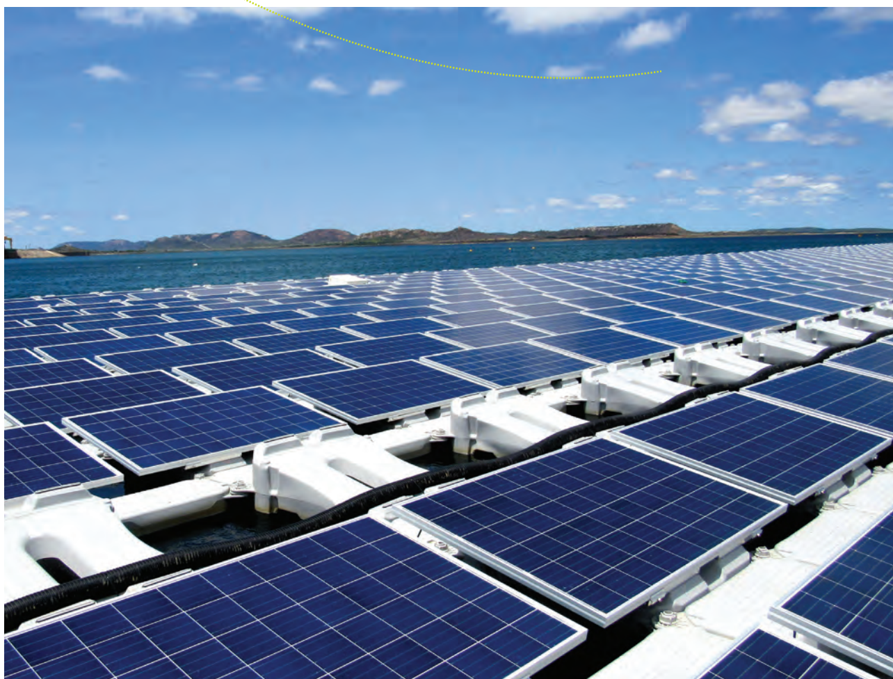
Placas solares flutuantes em Sobradinho. Eletrobras Chesf
